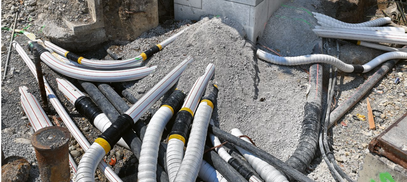
Komplexe Leitungsführung zu einem Elektroschacht
