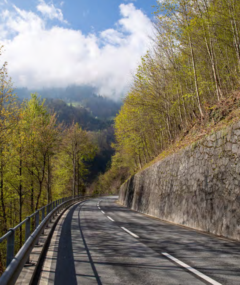
Bergstrasse mit seitlichem Fahrzeug-Rückhaltesystem
